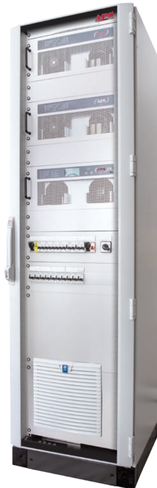
Widok szafy falownika w zabudowie modułowej
