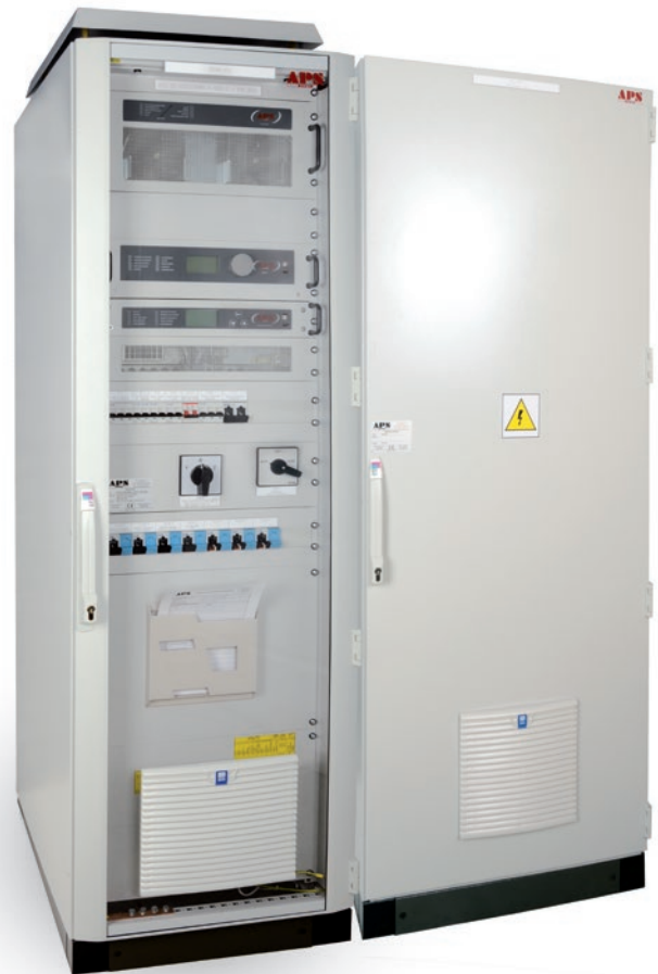
Widok szafy systemu UPS
