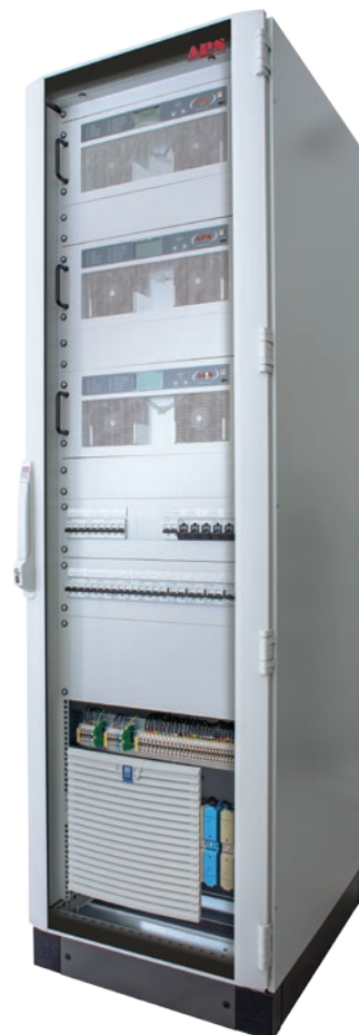
Widok szafy prostownika
