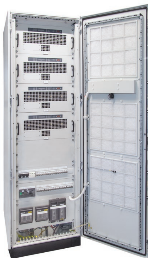
Widok szafy systemu UPS
