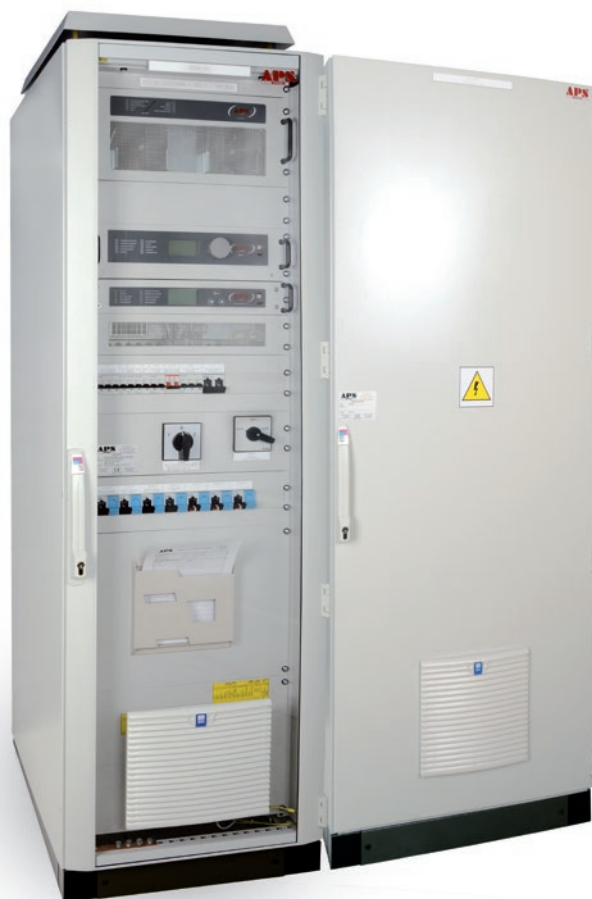
Widok szafy systemu UPS
