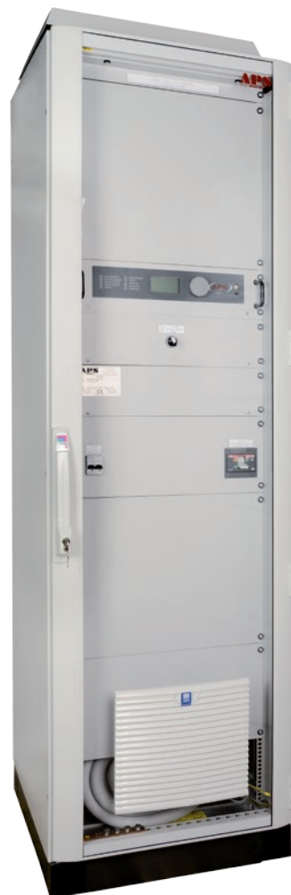
Widok szafy SKB
