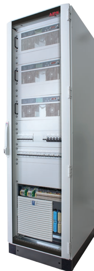
Widok szafy prostownika
