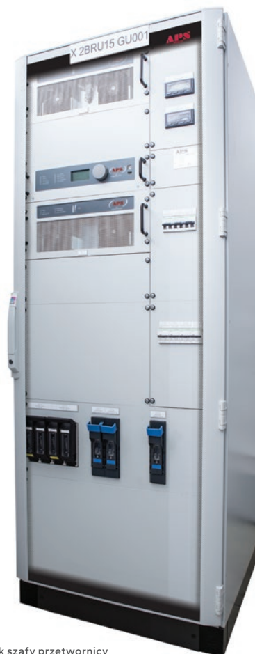
Widok szafy przetwornicy
