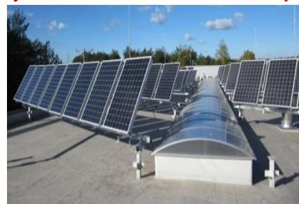
Rys. 10 Obiekt w Kozienicach z elektrownią solarną na dachu (ENAP S.A.)
