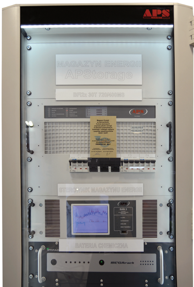
Rys. 3. System magazynowania energii APStorage z baterią litowo-jonową w zabudowie szafowej
